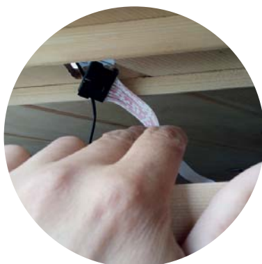
Ukázka propojení kabelů
