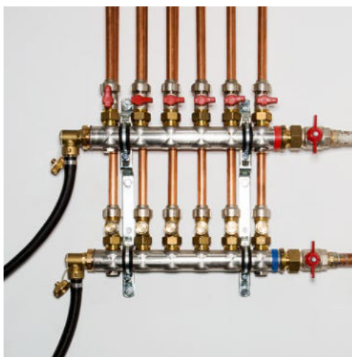
Proplachování radiátorů a plošných topných systémů
