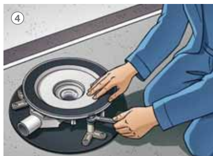
4 Umístěte odtok a zvukově izolační podložku a pomocí výškově nastavitelných montážních podpěr doladte nastavení na milimetr přesně.
