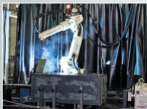
Robotizované svařovací CNC pracoviště
