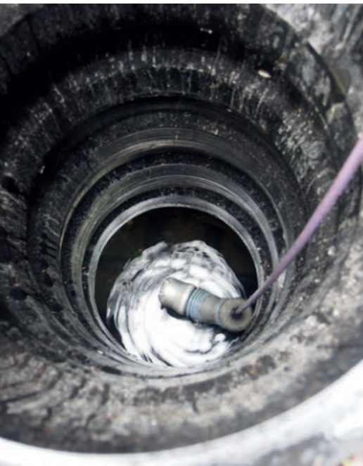
Vertikaler Zugang direkt über der Rigole
