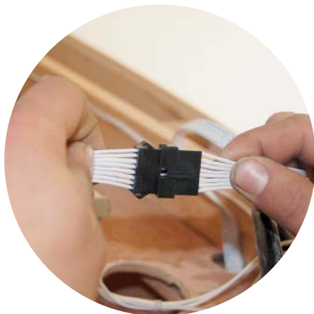
Ukázka propojení kabelů
