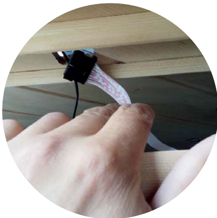
Ukázka protažení kabelů
