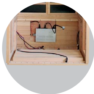
Umístění podlahového topidla
