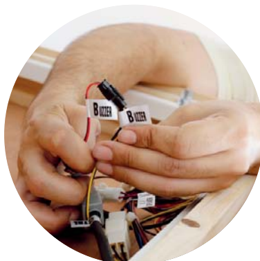
Ukázka propojení kabelů
